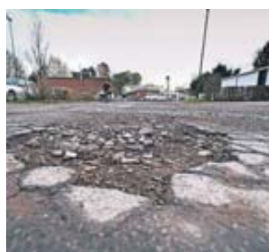
Die Straße Freiheitshagen ist in desolatem Zustand. RP-FOTO: BAUER
